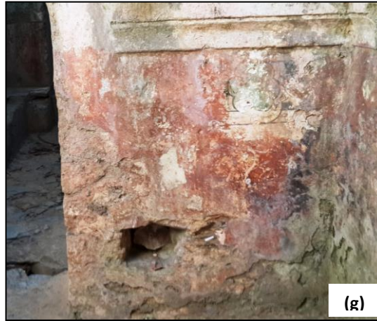
Foto. 2. Mamure Hamamı yapısal ve dekoratif malzemelerinde görülen bozulmalar; (a) Vejetasyon ve biyolojik oluşum, (b) Yüzeysel birikim/kirlenmeler/tuzlanmalar ve çatlaklanma (sağda) , (c) Parça kayıpları, (d) Derz harçlarında dökülmeler, (e) Sıvalarda dökülmeler, (f) Sıvalarda tuzlanmalar/kirlenmeler ve (g) Pigmentlerin dökülmeler/kirlenmeler (MAKLAB Arşivi)
