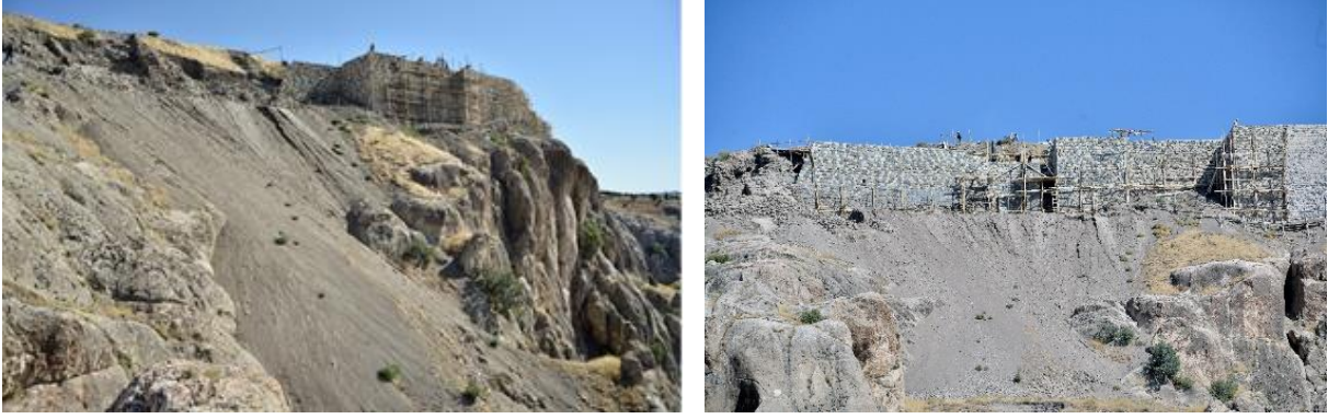
Foto. 11: Harput İç Kale güney suru batı ucu restorasyon öncesi ve sonrası (3. Bölüm)
