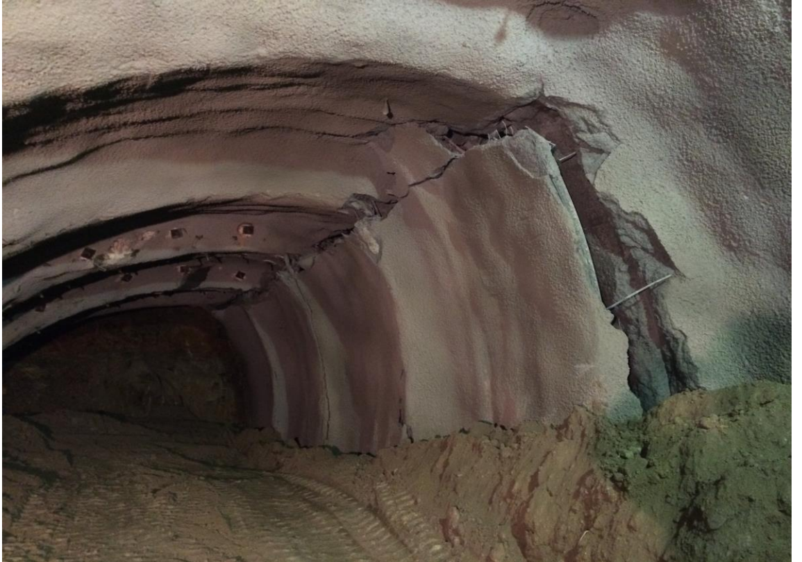
Resim 8.15 Kazı destek sisteminin mevcut yanal yüklerle yetersiz kalmasında dolayı meydana gelen deformasyonlar
