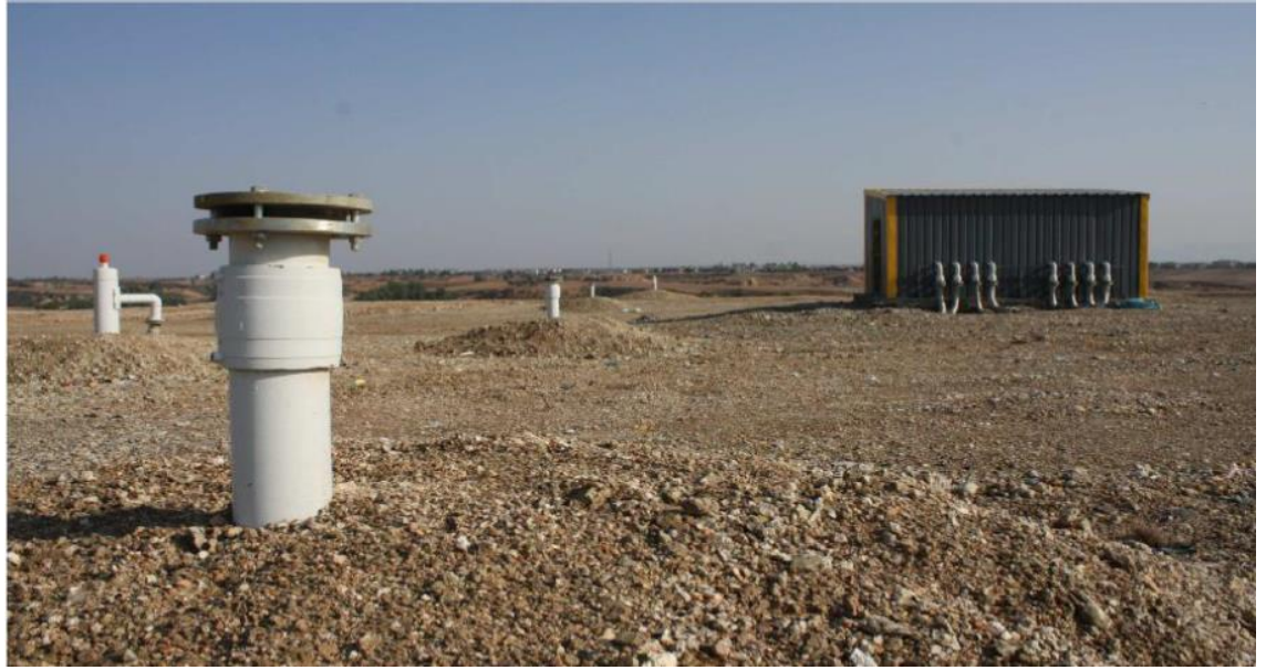
Resim 3.4 Depo gazı toplama tesisi [55]
