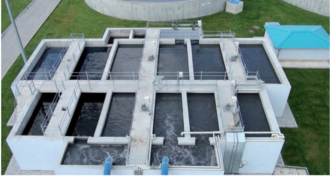
Şekil 9. Yavaş karıştırma (flokülasyon) ünitesi[36]
