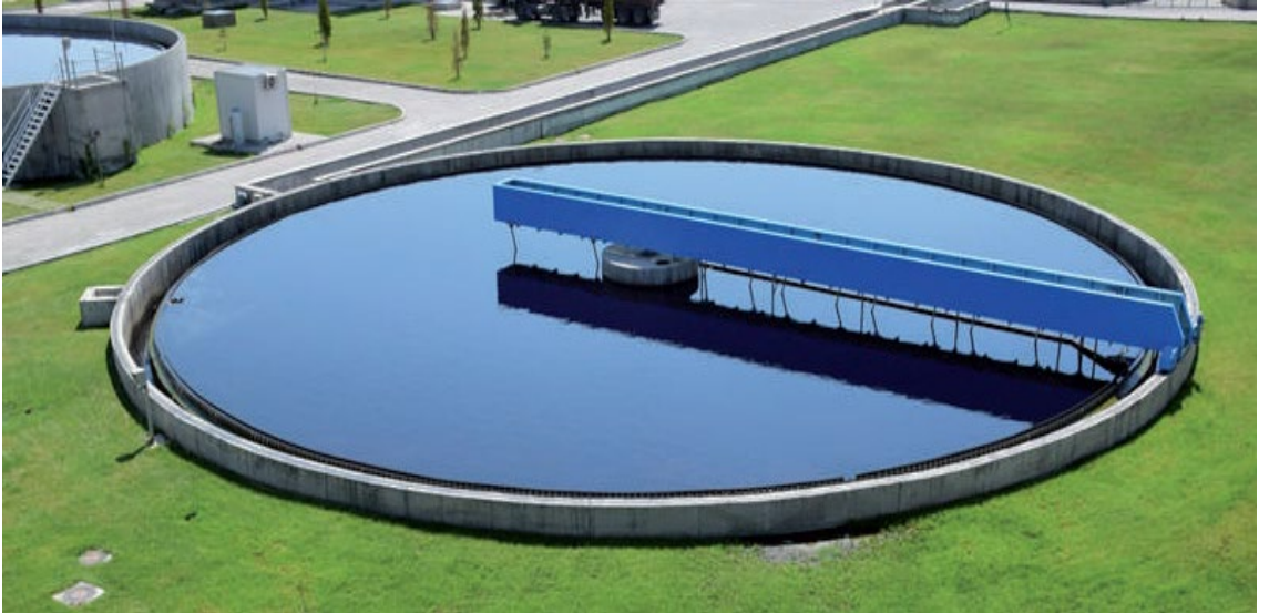
Şekil 12. Son çöktürme havuzu[36]
