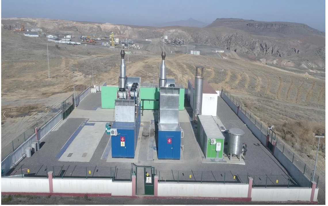
Resim 5.4.Nevşehir Düzenli Çöp Depolama Sahası Gaz Motorları
