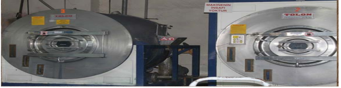
Şekil 3.6. Gürkar Tekstil Yıkama Bölümünden Bir Görünüm
