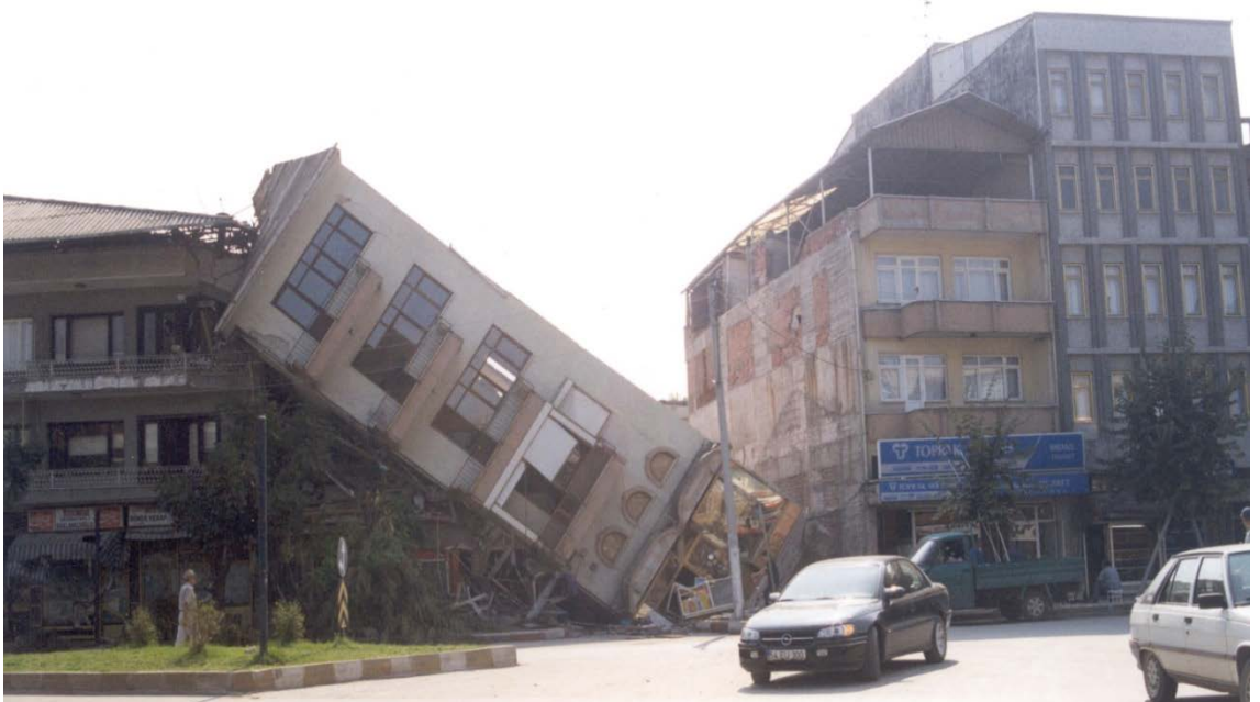
Resim 3.2. 1999 Kocaeli depreminde meydana gelen sıvılaşmaya yapı hasarları
