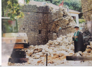
Fotoğraf 10: Şeyh Ali Hormova Tekkesi, caminin onarımdan önceki durumu.
