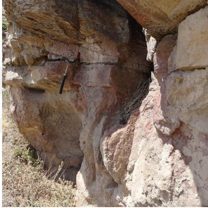
Şekil 1.7 Çevresel etkilere karşı farklı direnç gösteren ardalanmalı kaya kütlelerinde oluşan potansiyel duraysız bloklar (Göre)
